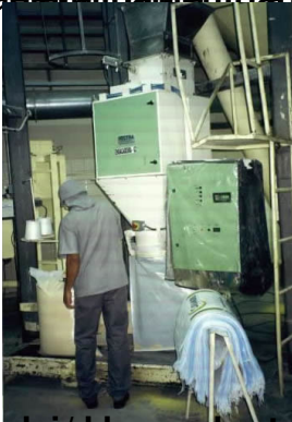
E06 Ensacadeira boca aberta com pré pesagem
